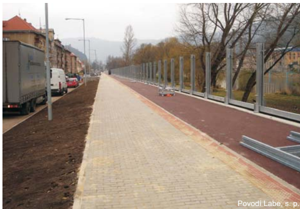
Abb. 3.1-6: Deichlinie mit mobiler Hochwasserschutzwand in Ústí nad Labem
