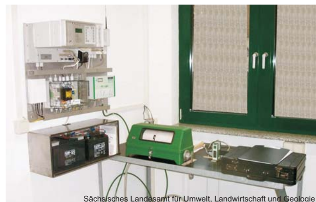
Abb. 4.2-3: Redundante Ausrüstung des Pegels Aue 3 an der Zwickauer Mulde
